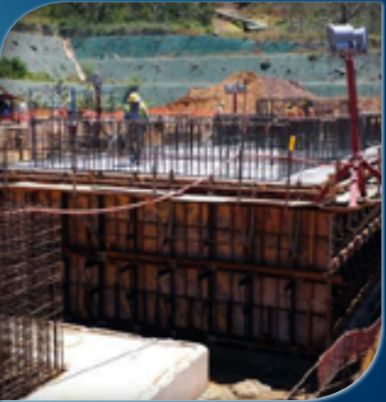
LAS PAILAS II GEOTHERMAL POWER PLANT
